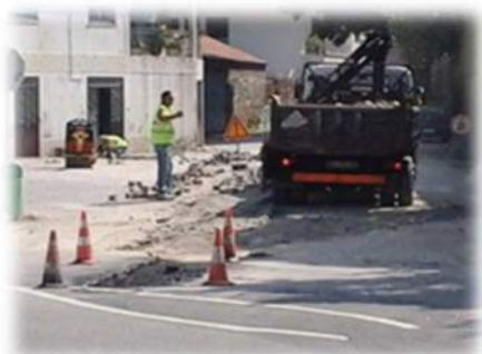
Rede de saneamento: Largo Casa da Torre
